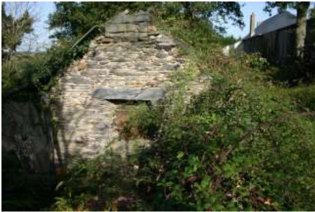
Four avant rénovation
